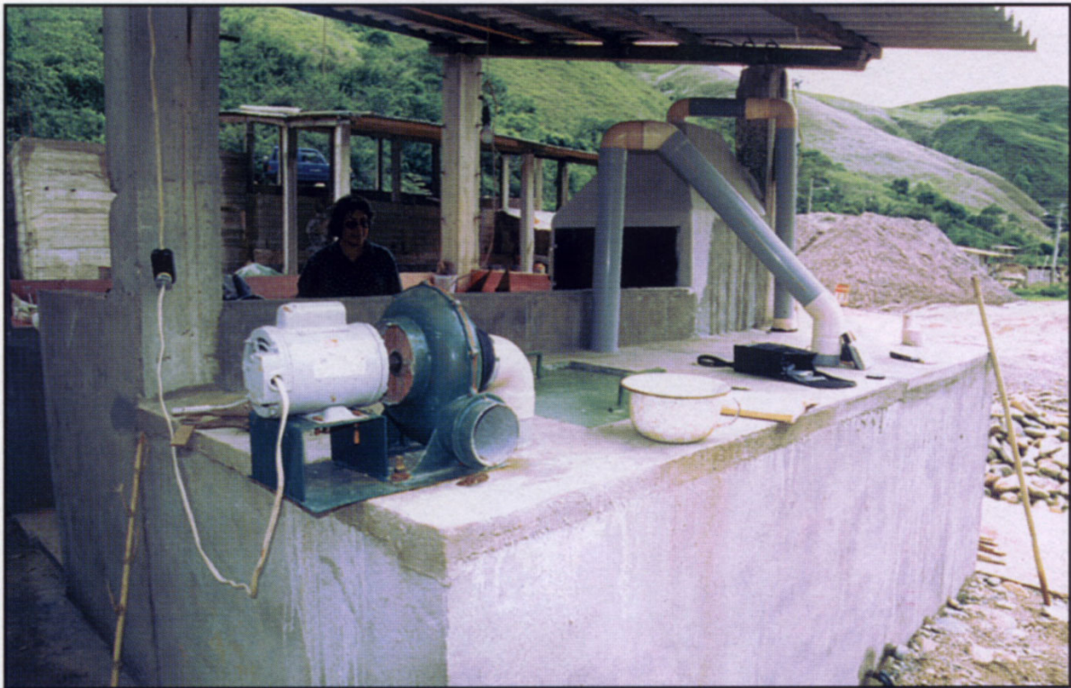
53. Filtro de carbón vegetal y lechada de cal para gases \text{NO}_x (Zaruma, Ecuador)
